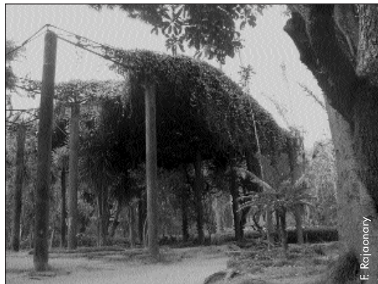
Shadow house in the beginning of the rehabilitation / L'ombrière à son état initial
